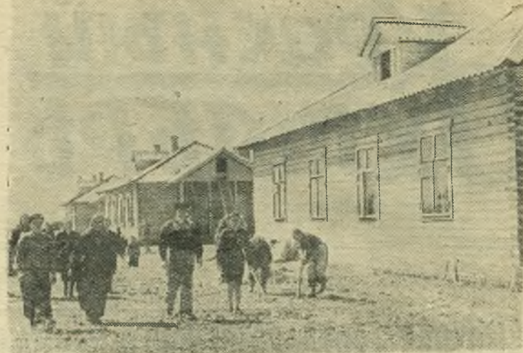
Алтайский край. В Златополинской МТС развернулось большое строительство. Здесь сооружаются типовые мастерские, гаражи для тракторов и комбайнов, гараж для автомашин, склад для запасных частей, электростанция, баня, водопровод, жилые дома.
