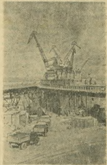
Куйбышевгидрострой. Готовя достойную встречу 37-й годовщине Великого Октября, коллектив 1-го участка района № 1 сооружения ГЭС досрочно выполнил девятимесячный план укладки бетона. До конца месяца были уложены еще тысячи кубометров бетона. Гидростроители приступили к бетонированию последней плиты водобоя гидростанции.
