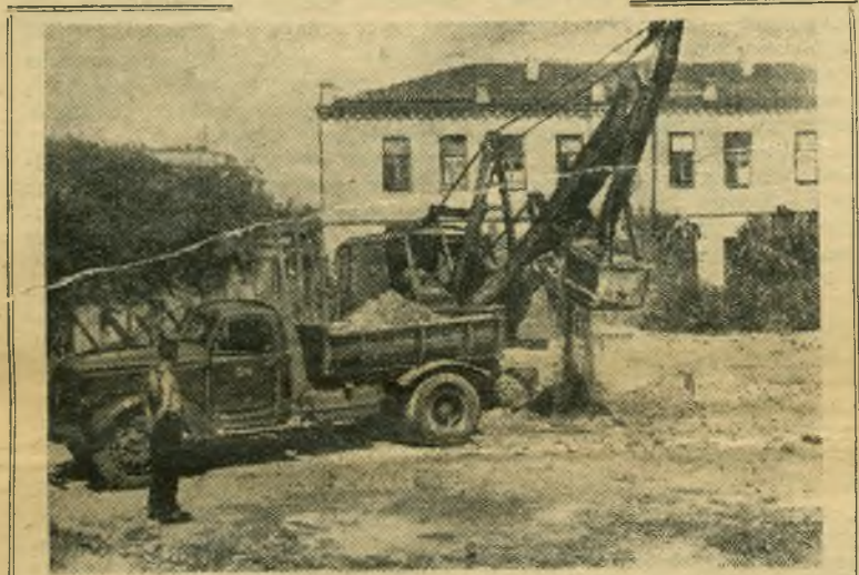
На Советской улице стройтрестом № 112 заканчивается строительство 53-квартирного четырехэтажного жилого дома. Сейчас в доме идут отделочные работы. Напротив этого дома, на другой стороне улицы, будет строиться второй такой дом. Сейчас здесь роется котлован под фундамент. НА СНИМКЕ: экскаватор за выемкой грунта из котлована. Фото А. Власова.
