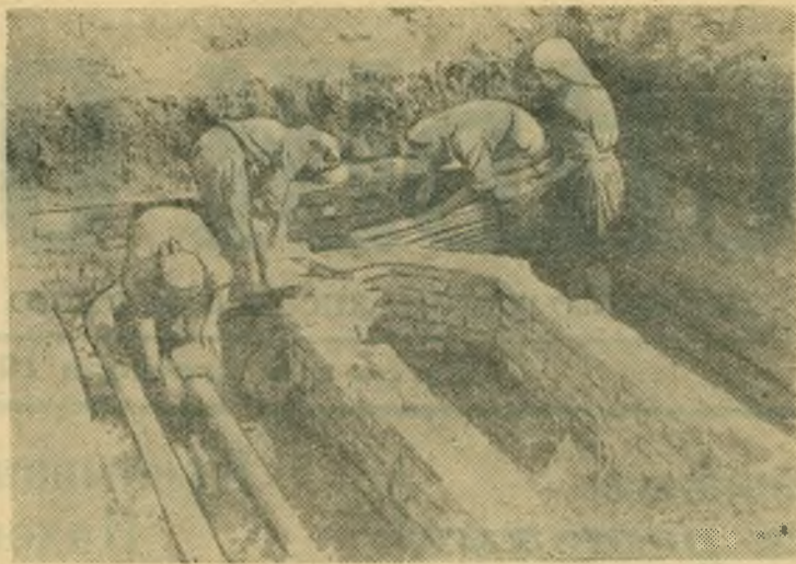
На строительстве завода кузнечно-прессового оборудования. НА СНИМКЕ: бригада тов. Устюшиной утепляет коммуникации теплотрассы.
